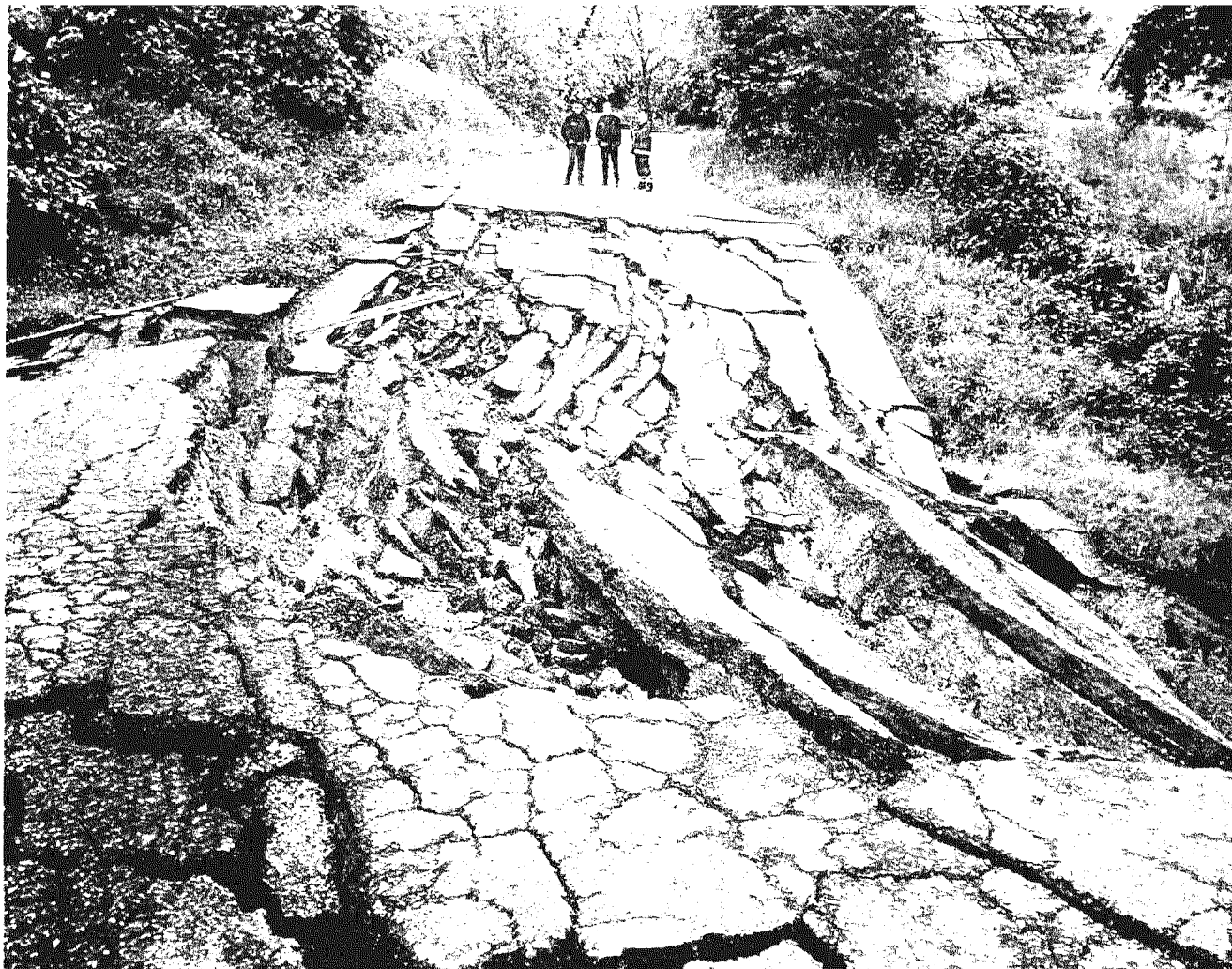
Bagno di Romagna. Il sopralluogo effettuato su una strada dissestata dopo una frana dovuta al maltempo, il 20 maggio scorso
