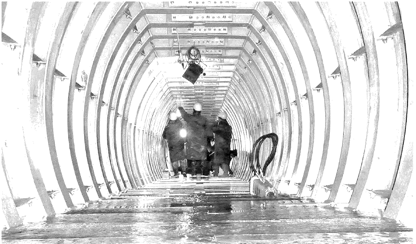
Manutenzioni. L'intervento nella galleria Pavoncelli del canale principale della rete di Acquedotto Pugliese
