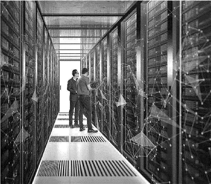
Il nodo. Minacce cyber in aumento per le infrastrutture tech (in foto data center)
