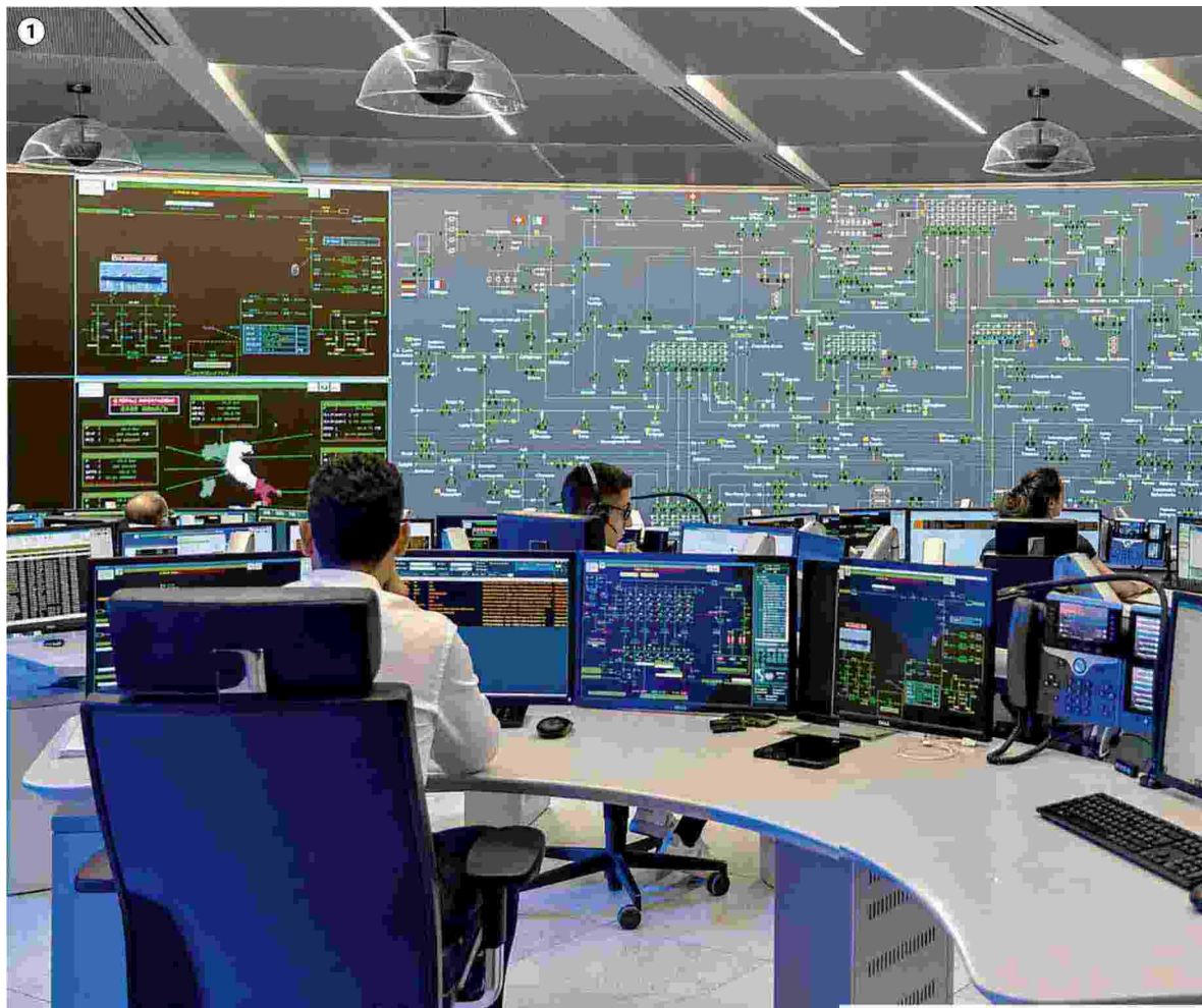
① Nel centro di dispacciamento di Snam, alle porte di Milano, il monitoraggio di rete e stoccaggi
